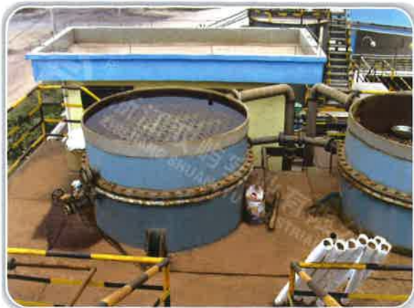
金源集团废水处理应用现场
